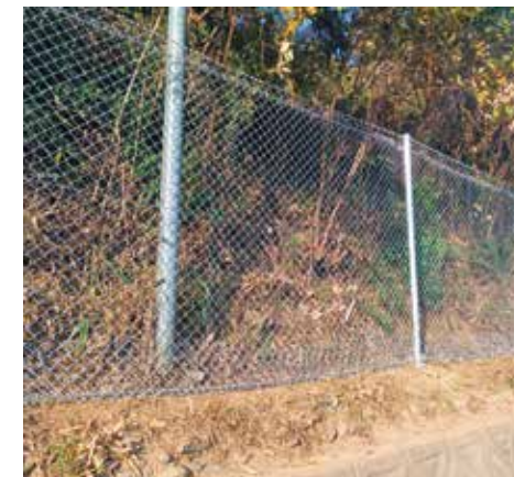
背面の斜面が迫った法尻
