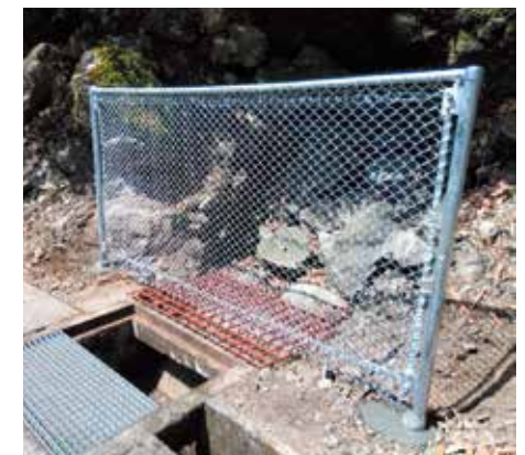
沢部の落石集中箇所に設置
